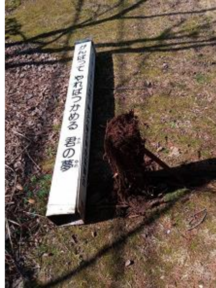
南小公園の標柱(土台の木が腐食)
